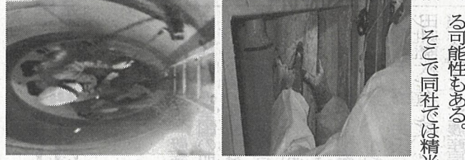
機器内部の分解清掃、フィルター交換も
